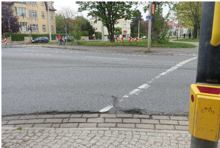
Foto: Ampelkreuzung Karcherallee / Übergang zum Großen Garten Richtung Wiesenstraße, Störung in Fahrbahn erkennbar, auf der linken Seite Radfahrer überquert Straßenbahngleise der Stübelallee (ungesicherter Übergang für Passanten)
