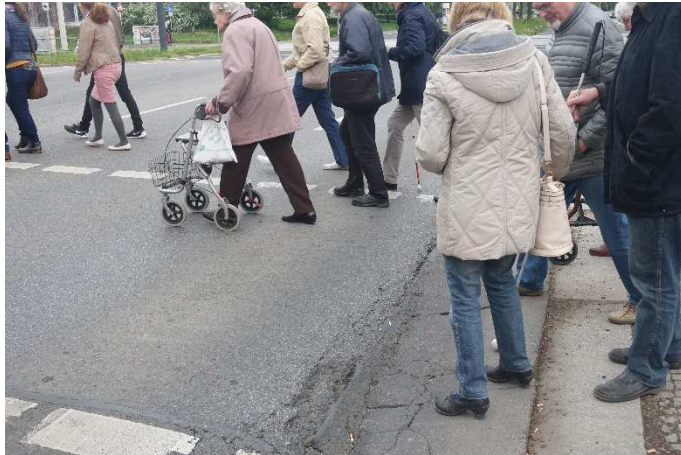
Foto: An der Ampelkreuzung Karcherallee / Übergang zum Großen Garten, Grünphase, Start der Querung, Aufnahme der Straßenbeschaffenheit, Passanten queren aufgrund der schlechten Beschaffenheit der Strasse zum Großteil außerhalb der Markierung die Strasse
