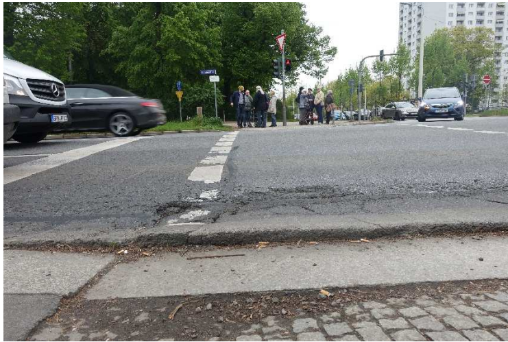
Foto: Nahaufnahme An der Ampelkreuzung Karcherallee / Übergang zum Großen Garten: hohe Delle als Stolperfalle beim Übergang Fussweg auf die Fahrbahn
